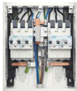
Abbildung 4: Spannungsabgriff aus UAR (ungezählt) mit Sicherungsbox auf Geräteträger
