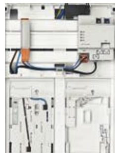
Abbildung 6: Spannungsabgriff aus BKE-I (ungezählt) mit Sicherungsbox
