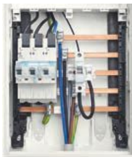
Abbildung 3: Spannungsabgriff aus UAR (ungezählt) mit LS-Schalter auf Geräteträger
