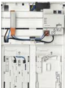
Abbildung 5: Spannungsabgriff aus BKE-I (gezählt) mit Sicherungsbox
